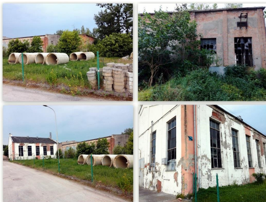
Rysunek 8. Stan techniczny budynków byłej cukrowni w Choceniu
