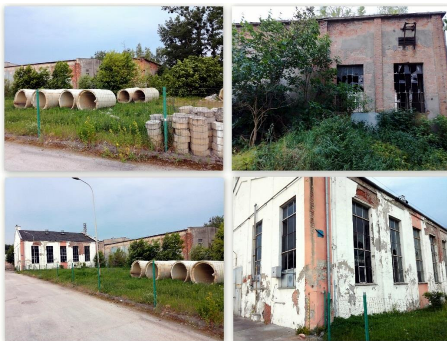
Rysunek 8. Stan techniczny budynków byłej cukrowni w Choceniu
